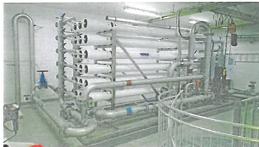
Membranfilter i 1. etasje.
